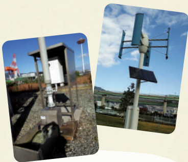
工場開設当時から設置されている排水処理水を利用した小型水力発電(左)と小型風力発電(右)。発電量は大きくないものの、エネルギーを無駄にしないという例として工場の姿勢を内外に示しています。
