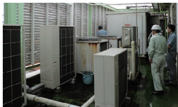
省エネ設備(空調設備)の更新
